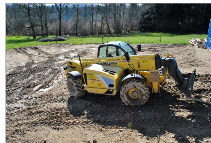
Photographie 49 : Exemple de tassement et d'ornières créés par les engins de chantier
